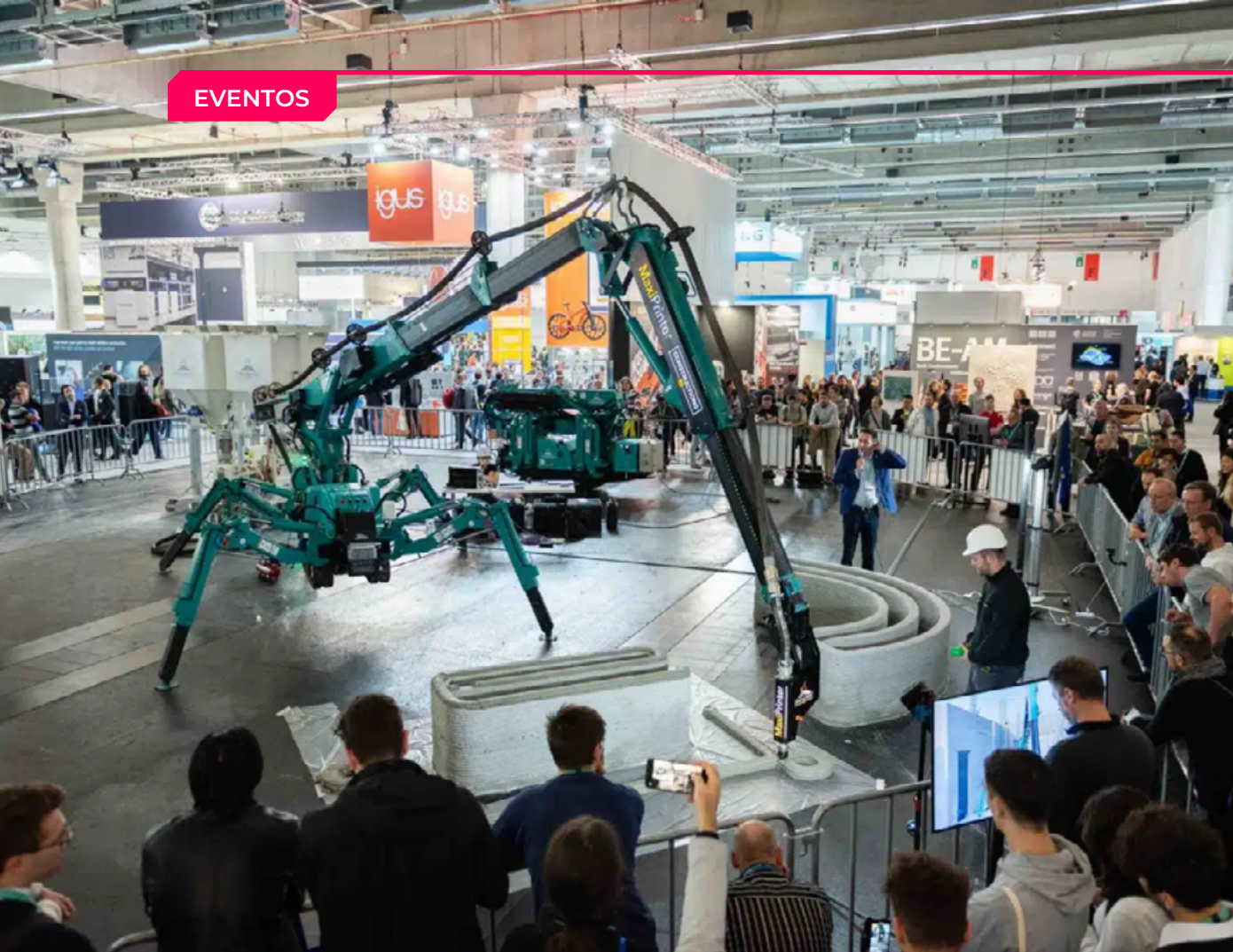
Demonstração da impressão 3D de concreto da Constructions 3D. Foto: Mathias Kutt
